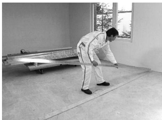
a. Posa delle guide a "U" sul pavimento su strisce perimetrali isolanti
